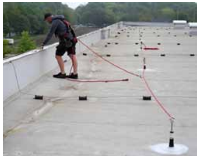
Die Anschlagpunkte im eingebauten Zustand, die temporär mit einem Seilsicherungsseil ausgestattet werden
